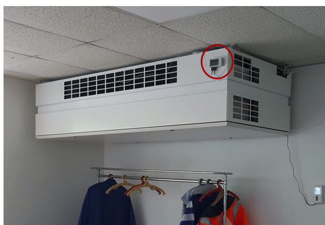
FIGURE 32 VMP DFST ALDES VEX 308 installée dans une salle de formation (vue intérieure)
