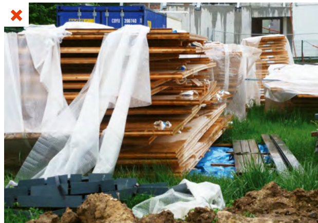
Exemple d'un stockage d'éléments bois mal protégés des intempéries et en contact avec l'humidité du sol. ©AQC
