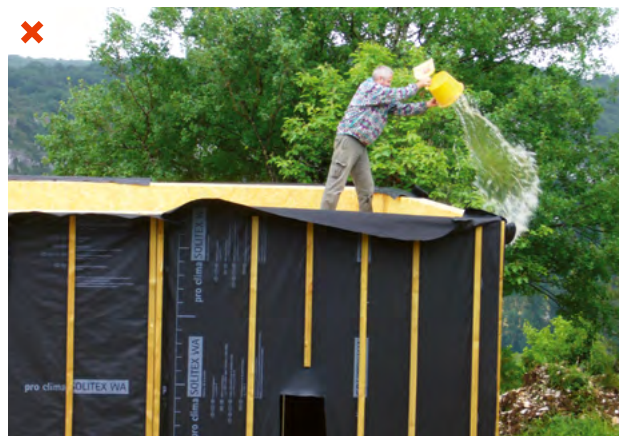
Le bâtiment non protégé (notamment les éléments bois au niveau de la toiture terrasse) est resté longtemps exposé aux intempéries avant d'être mis hors d'eau. ©AQC
